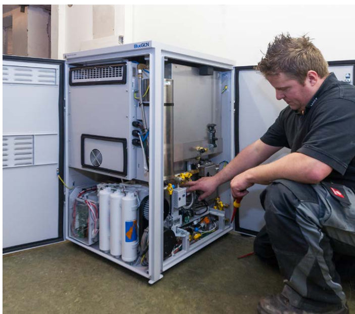
Während der zweijährigen Testphase waren die Brennstoffzellen absolut zuverlässig im Betrieb und erzielten eine hohe Energieausbeute.
